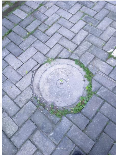
Gambar 4.10. Inlet IPAL Komunal Pedalangan
