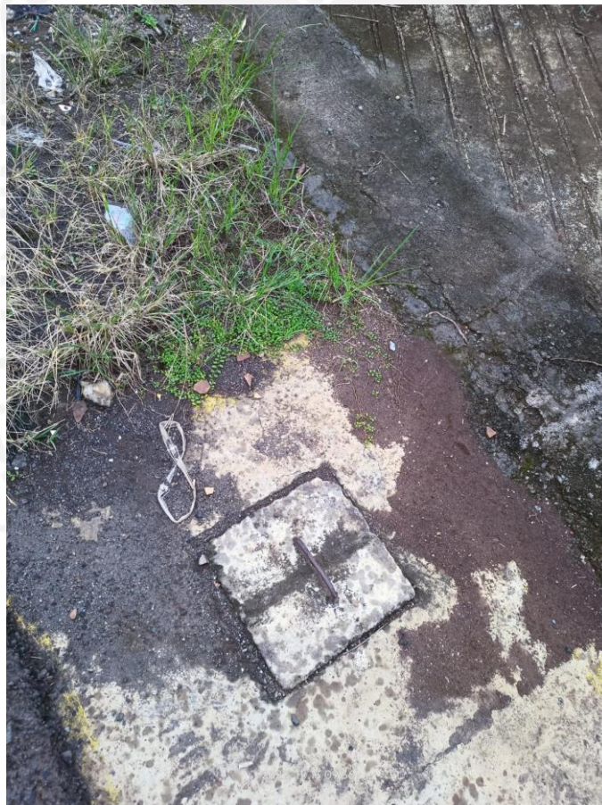
Gambar 4.15. Inlet IPAL Komunal Podorejo
