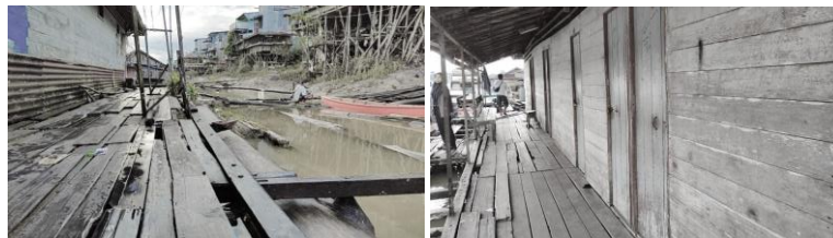
Gambar 7. kondisi eksterior dari bangunan terapung yang mengalami deteriorasi Sumber: Dokumentasi pribadi 2021
