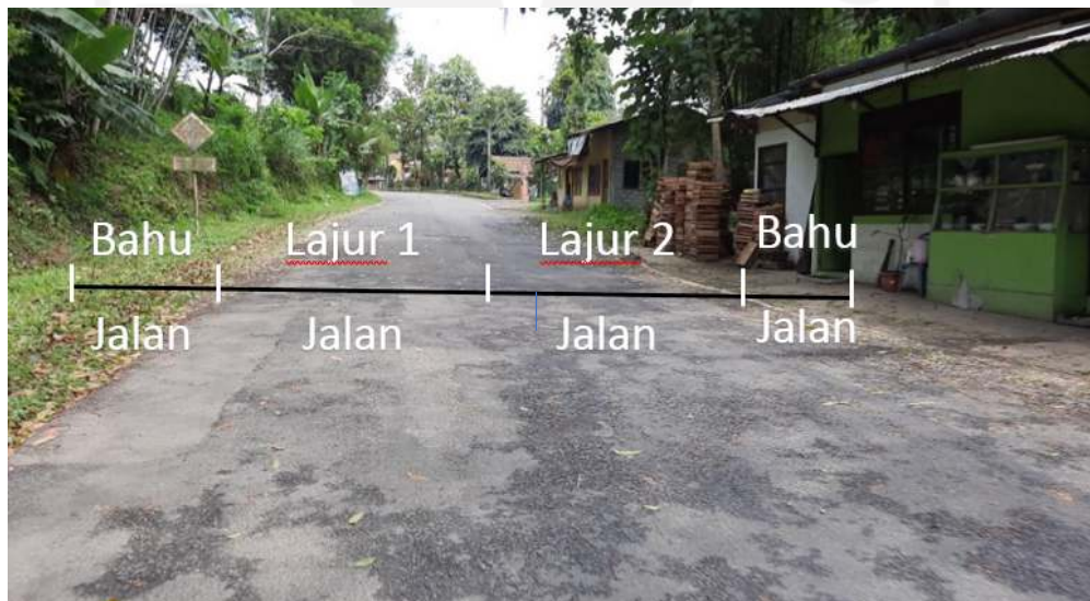
Gambar 5.1 Kondisi Eksisting Jalan Kertek-Kepil
