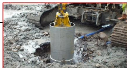
4. Penyemprotan air secara kontinu pada sisi luar casing untuk mencegah keruntuhan dinding tanah
