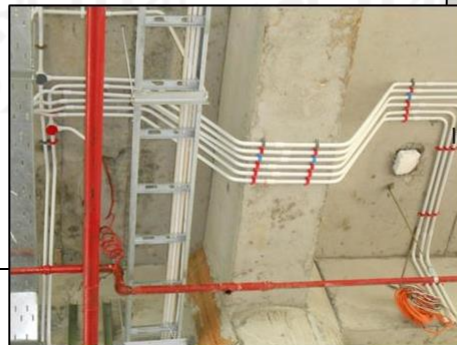
Instalasi listrik untuk penerangan
