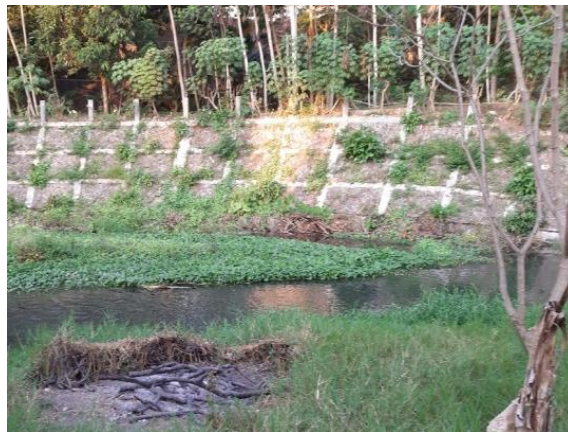
Gambar 14 Kondisi lereng sungai, Sinduadi
