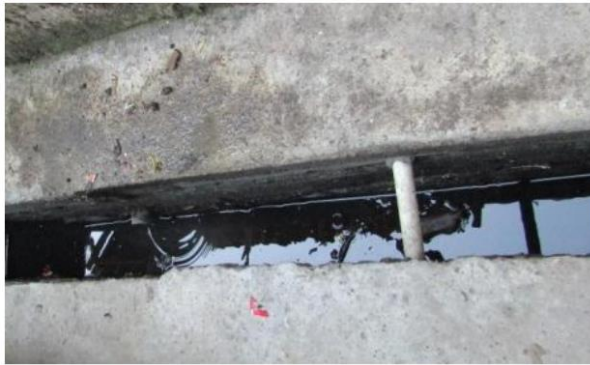
Gambar 4 Kondisi drainase di Morodemak
