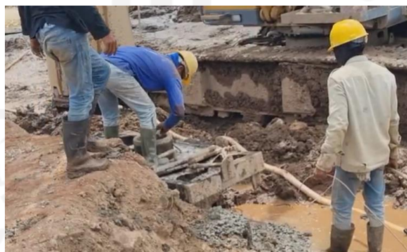
Gambar 5. 5 Pekerja Tergores Saat Membuka Kawat Sling Pada Pipa Tremie
