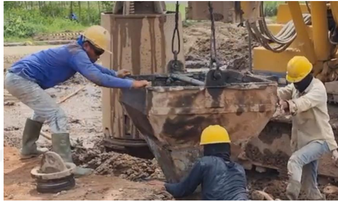
Gambar L-1. 3 Pekerja Tidak Menggunakan APD dengan Lengkap
