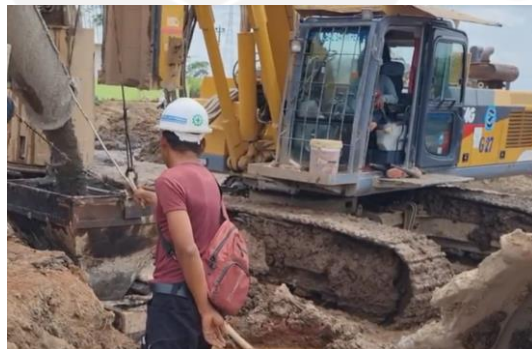
Gambar 5. 3 Alat Rotary Drilling Rig Tidak Seimbang
