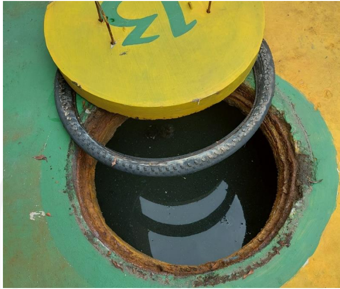
Gambar 4. 14 Air di unit anaerobic filter
