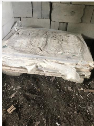
Gambar 4. 15 Papan atau Alas Paving Block (Sumber: Data Pribadi)
