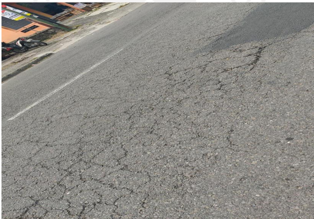
Gambar 1.2 Kerusakan Jalan Jenis Alligator Cracking
