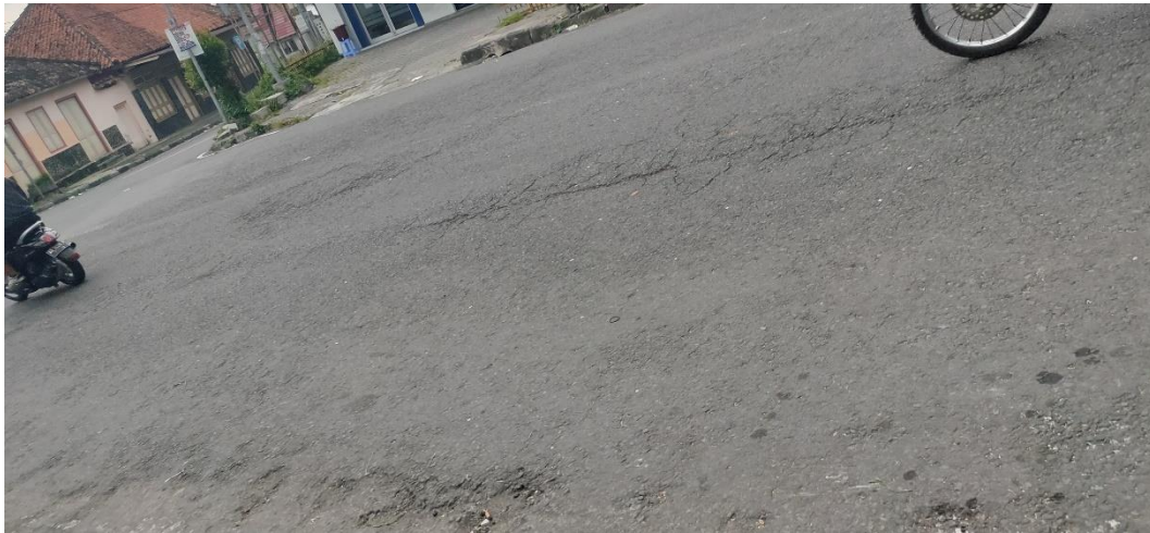
Gambar 1.3 Kerusakan Jalan Jenis Longitudinal Cracking
