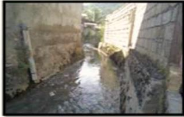
Gambar 5. 6 Penyempitan Saluran Drainase
