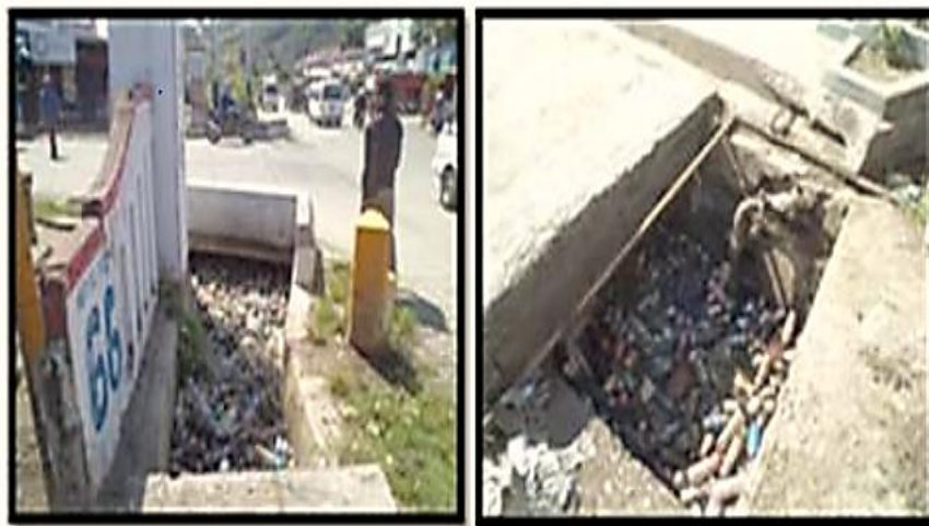
Gambar 5. 5 Pembuangan Sampah Di Saluran Drainase Pembuangan Sampah Di Saluran Drainase
