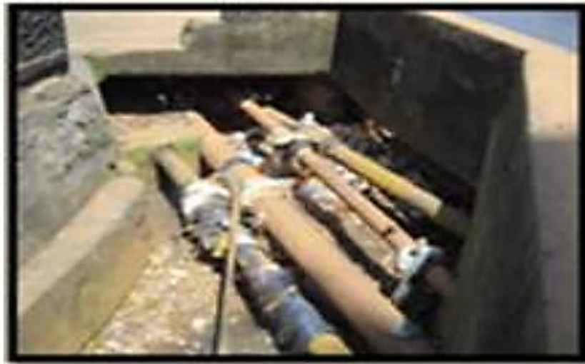
Gambar 5. 8 Pipa Air Di Saluran Drainase
