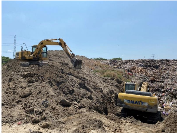
Gambar 4.15 Dua Unit Alat Berat Jenis Excavator Yang Sedang Beroperasi Di TPA Troketon Pedan Sumber : Dokumentasi Pribadi, 2021
