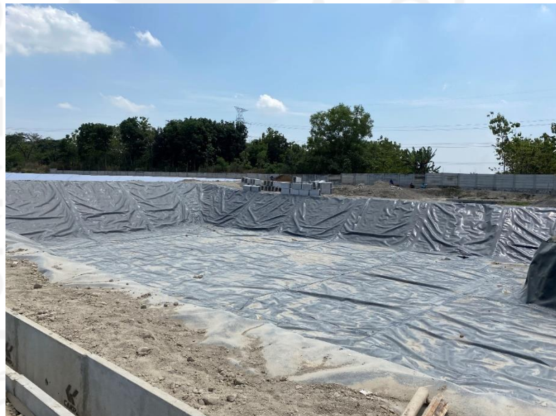
Gambar 4.6 Tampak Samping Sel 3 TPA Troketon Yang Belum Terisi Sehingga Masih Terlihat Lapisan Kedap Air
