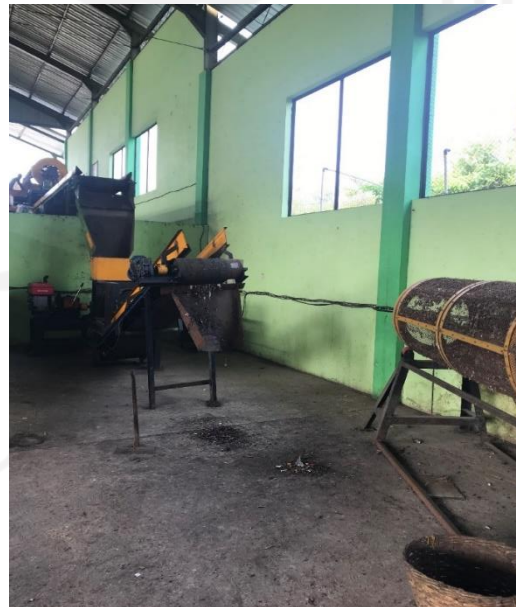
Gambar 4.12 Mesin Konveyor Tidak Terpakai Yang Menuju ke Mesin Komposter di Unit Instalasi Pembakaran Sampah Domestik TPA Troketon Pedan
