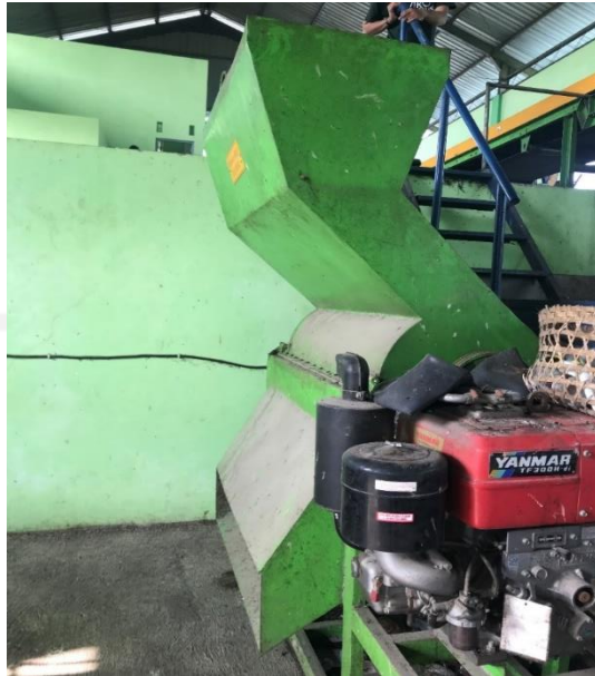
Gambar 4.11 Kondisi Mesin Pencacah Sampah Yang Rusak Dan Tidak Digunakan di Unit Instalasi Pembakaran Sampah Domestik TPA Troketon Pedan
