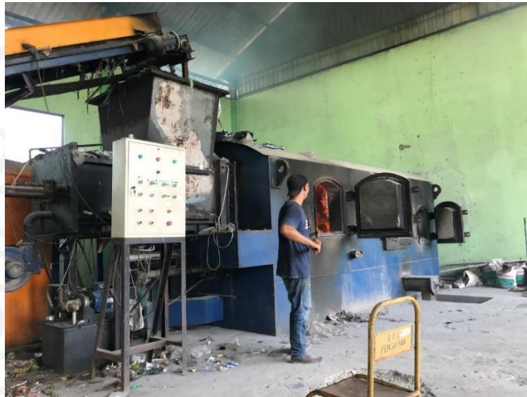
Gambar 4.10 Mesin Insinerator Yang Sedang Melakukan Pembakaran Sampah di Unit Instalasi Pembakaran Sampah Domestik TPA Troketon Pedan
