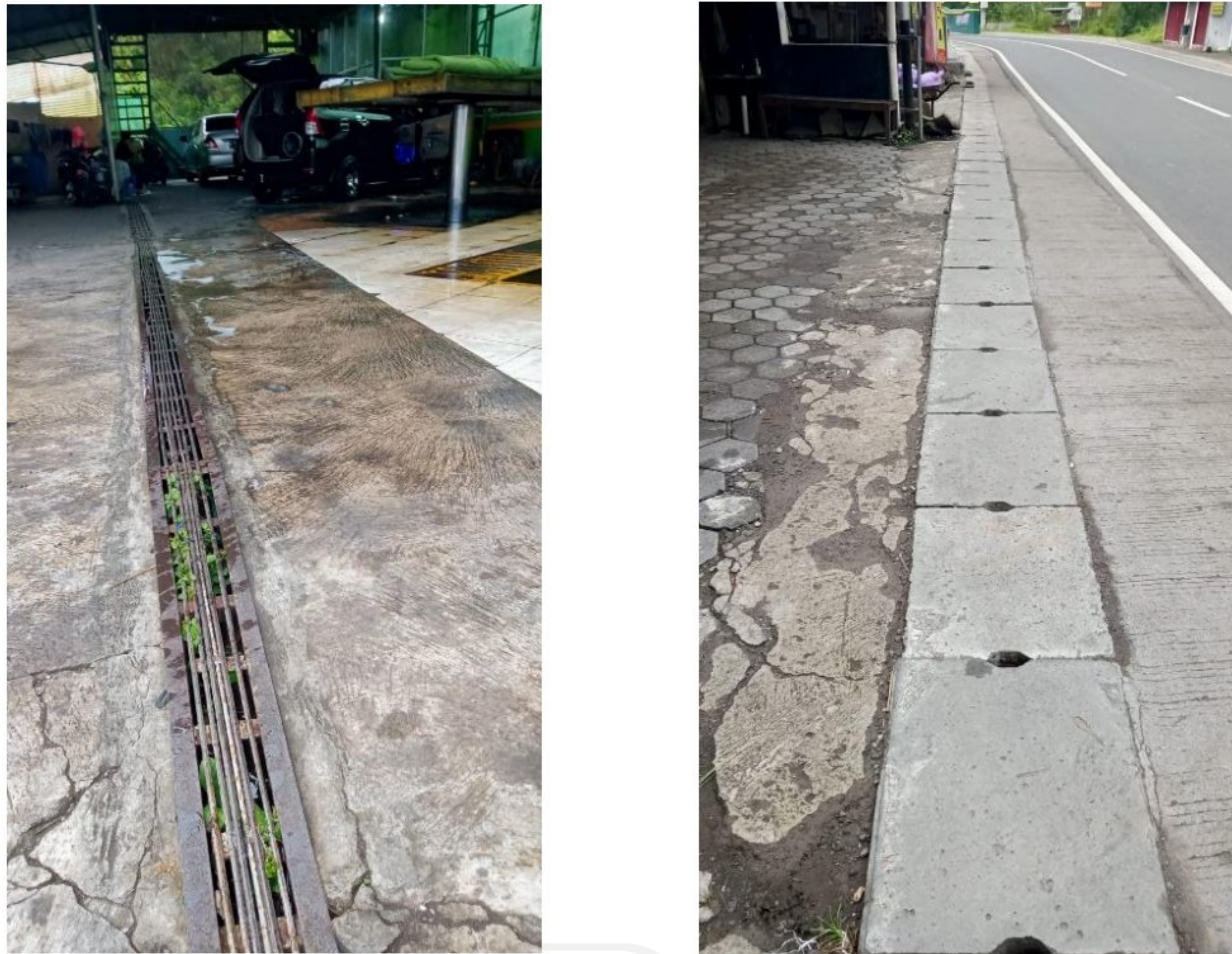
Gambar 4. 2 Drainase Tempat Cuci Kendaraan B
