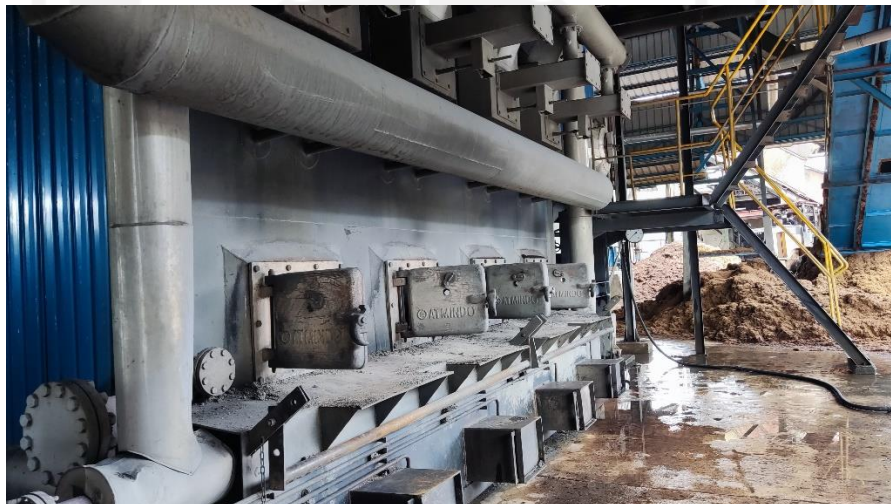
Gambar 4. 14 Mesin Boiler Tampak Depan
