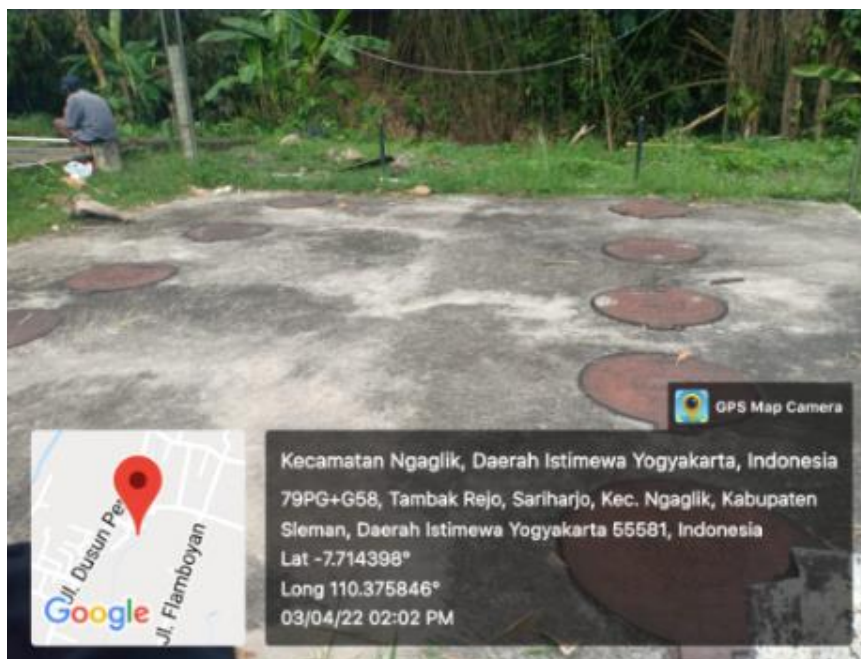
Gambar 4.3 Unit Pengolahan IPAL Komunal Tambakrejo Bersih
