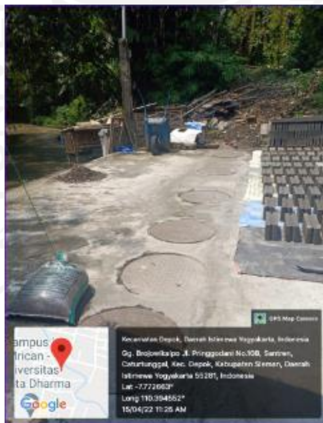
Gambar 4. 1 Unit Pengolahan IPAL Komunal Manunggal Pringgodani Sejati
