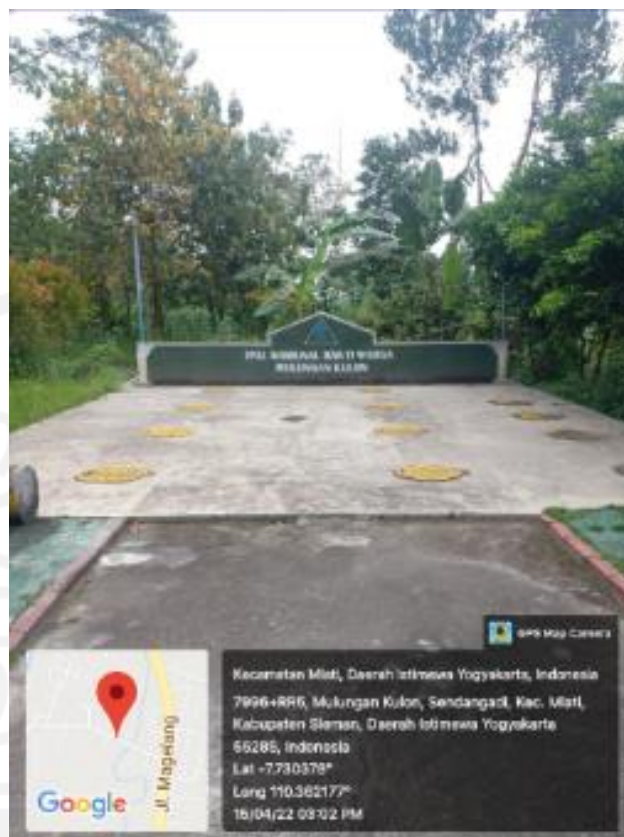
Gambar 4.2 Unit Pengolahan IPAL Komunal Bakti Warga
