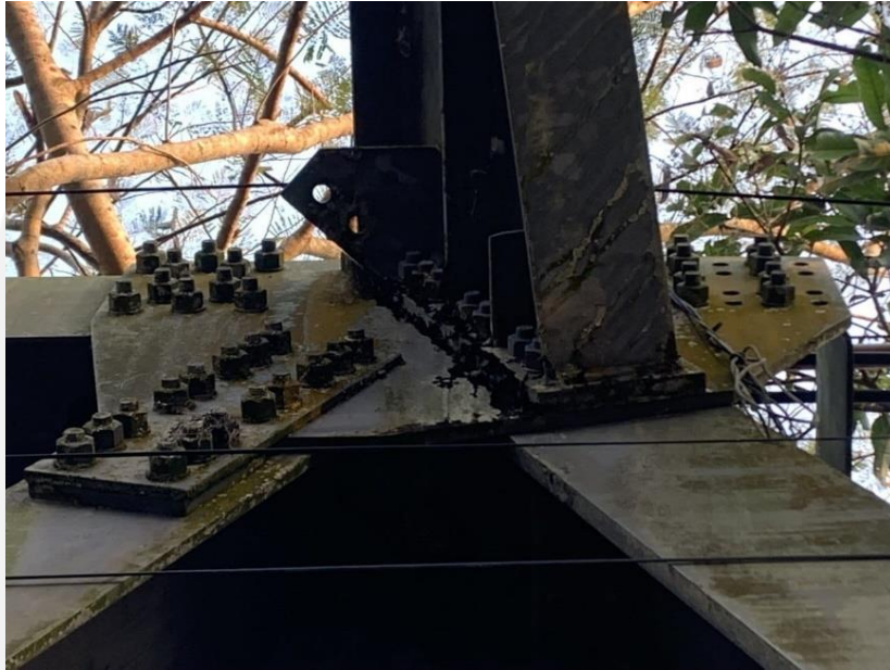
Gambar 5.28 Kerusakan pada Jembatan
