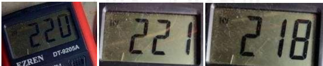
Gambar 4.11 Dokumentasi pengukuran tegangan aktual pada monitoring 1 lampu
