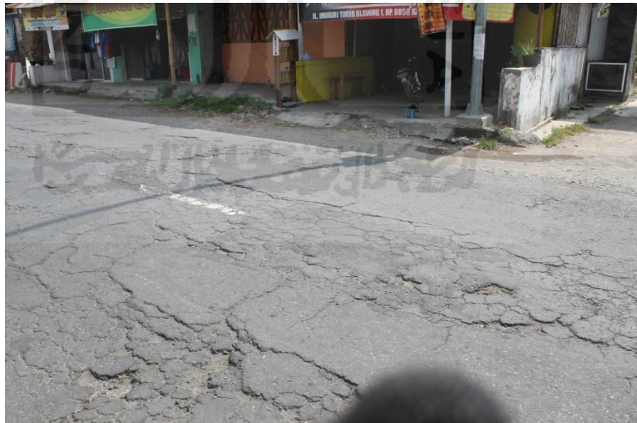
Gambar 1.1 Kerusakan Jalan Kulit Buaya dan Ravelling
