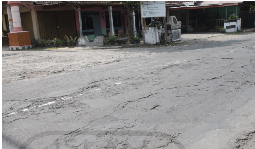
Gambar 1.2 Kerusakan Jalan Kulit Buaya, Cracking dan Ravelling (3/12/2016)
