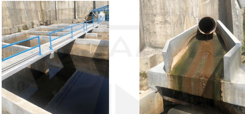
Gambar 4.1 Kondisi Eksisting IPAL TPA Piyungan
