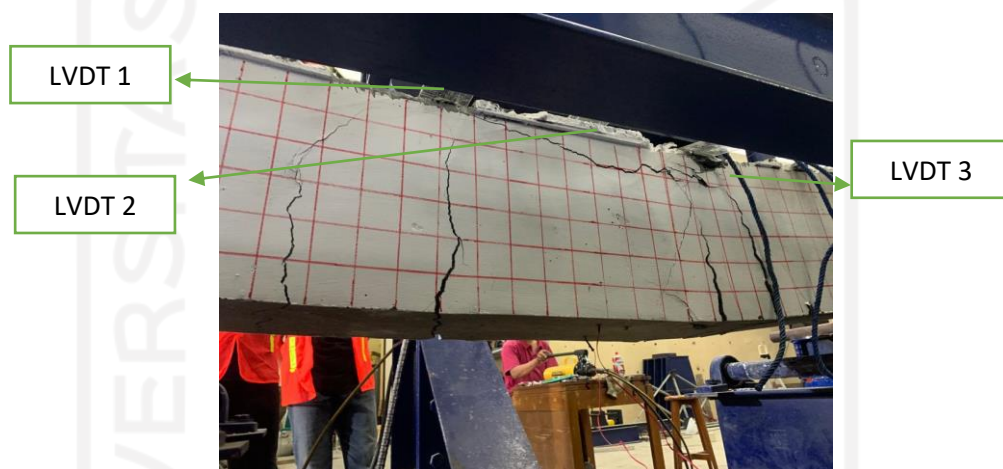
Gambar 5.16 Kerusakan Benda Uji Balok Sambungan Lewatan
