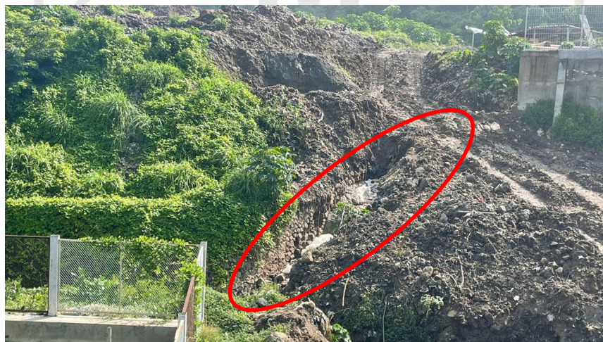
Lampiran 3. Kondisi Perbaikan Kolam Lindi TPA Piyungand dan terdapat genangan air lindi maupun point source air lindi
