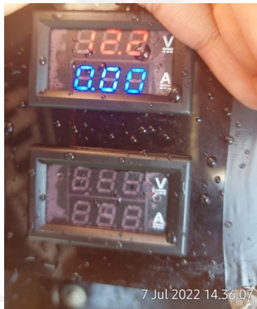
Gambar 5.4. Tegangan pada baterai setelah dilakukan pengisian daya
