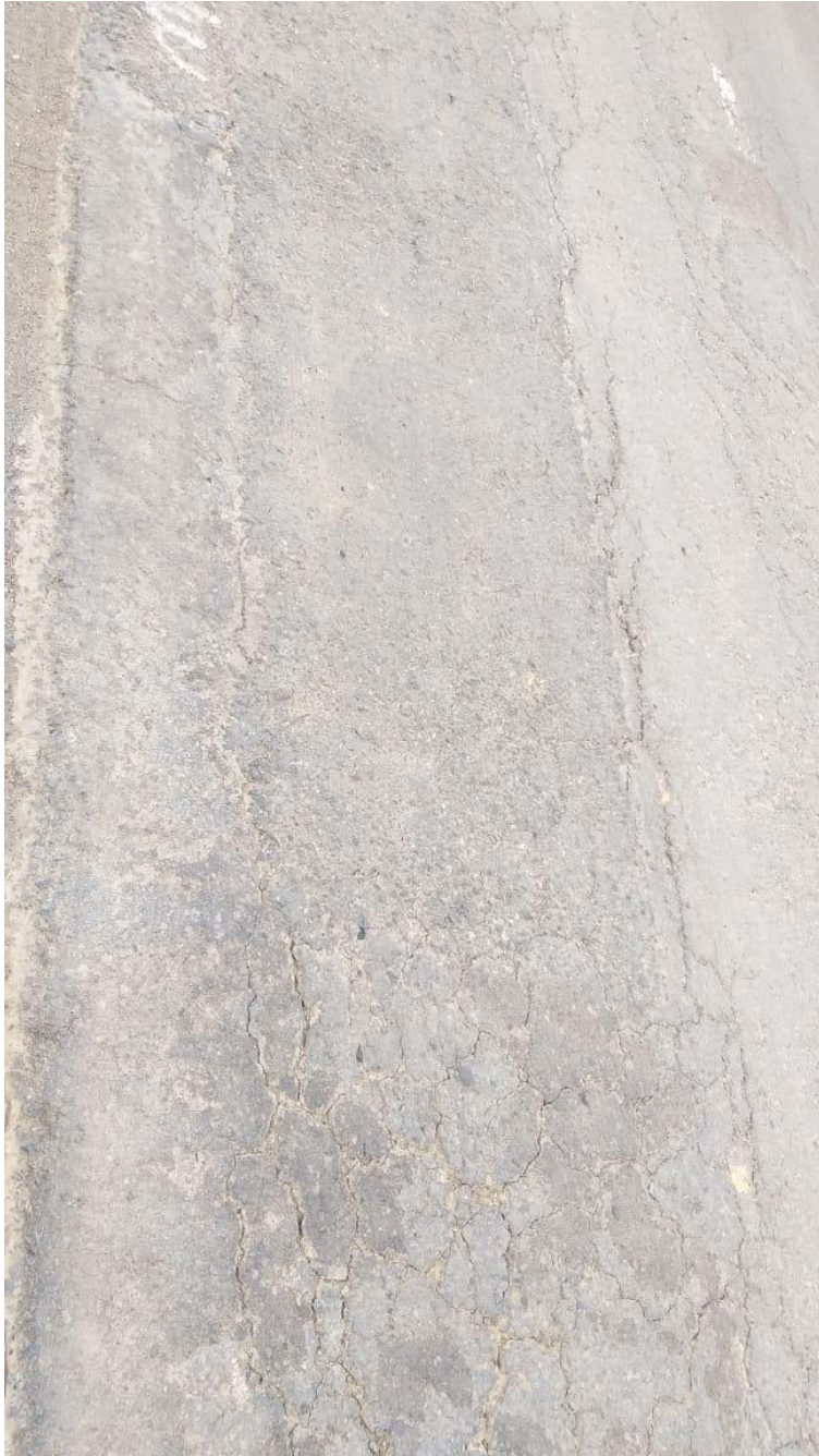
Lampiran 1 Gambar. 2 Kerusakan pada Ruas Jalan Kaliurang km 15-16
