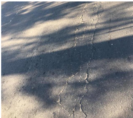
Gambar 1. 2 Kerusakan Retak di Ruas Jalan Kaliurang km 15-16
