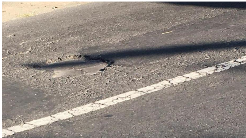
Gambar 1. 1 Kerusakan Lubang di Jalan Kaliurang km 15-16
