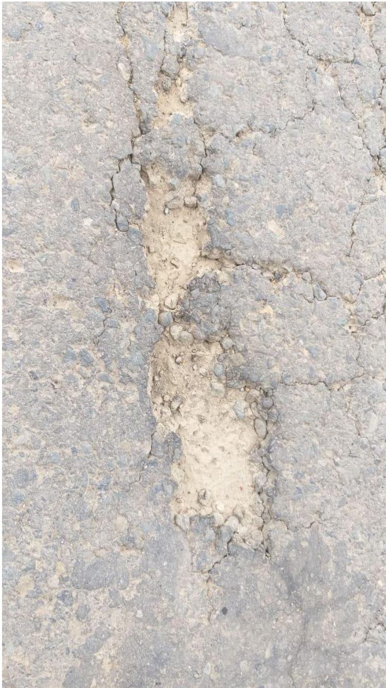
Lampiran 1 Gambar. 3 Kerusakan pada Ruas Jalan Kaliurang km 15-16
