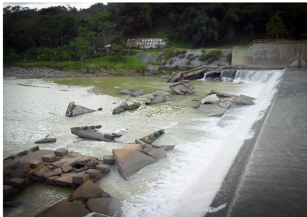
Gambar 1.1 Kerusakan Pada Kolam Olak di Bendung Kaligending
