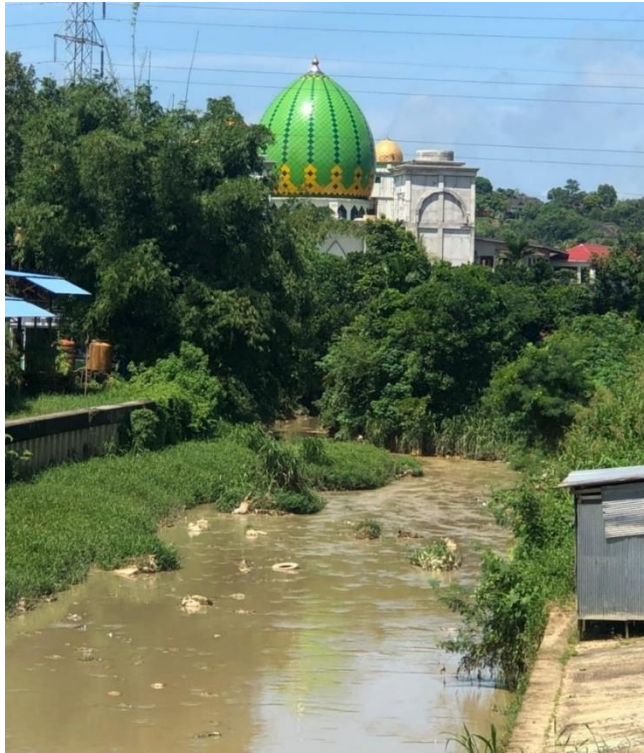
Gambar 4. 2 Penyempitan Dimensi Drainase Akibat Rumput Liar
