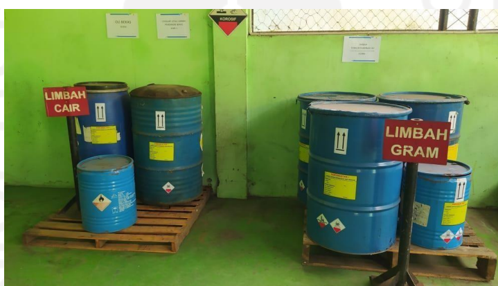
Gambar 4. 20 Proses Penyimpanan pada Unit IV (Sumber: PT PLN Pusharlis Unit III dan IV Bandung)
