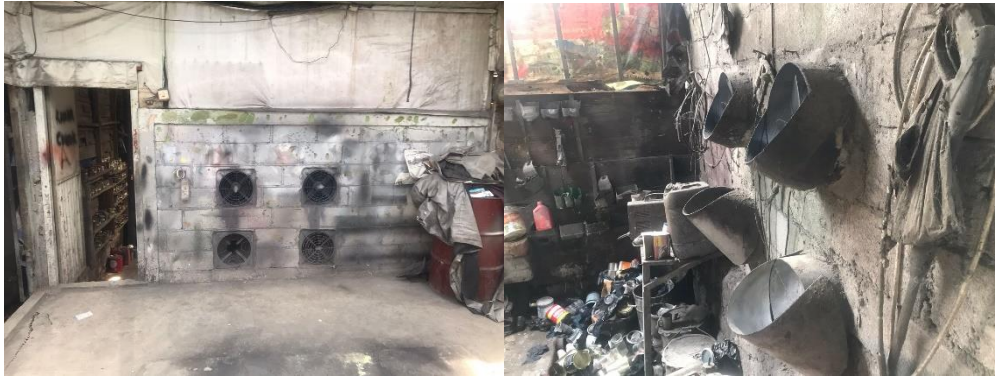
Gambar 4. 18 Kondisi Eksisting Exhausted Fan di Bengkel X
