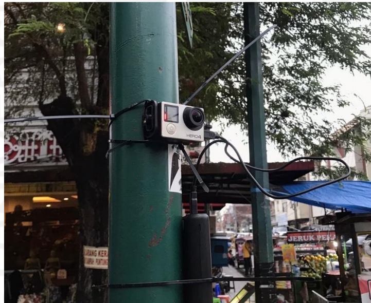
Gambar L-15.4 Kamera CCTV pada Simpang Empat Suryatmajan
