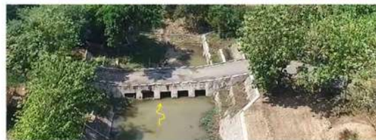
Kondisi Jembatan Benam di Sebalah Hilir Outlet dan Spillway
