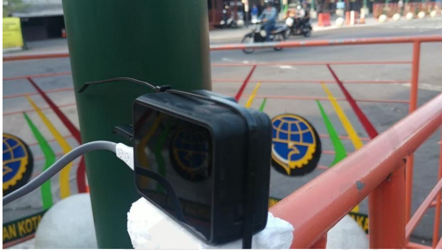
Gambar L-15.1 Kamera CCTV Pada Simpang Empat Pasar Kembang
