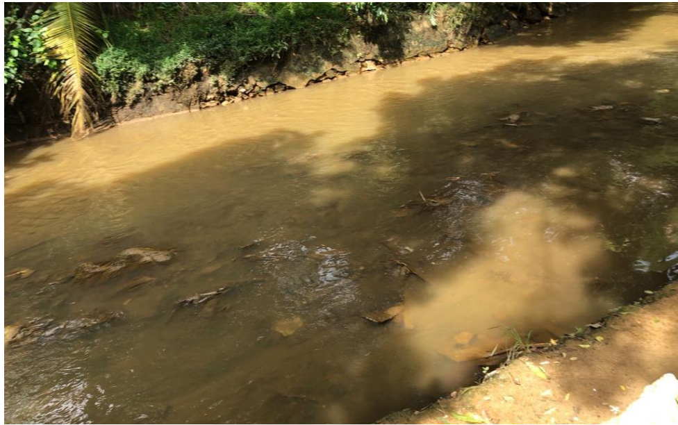
Gambar 5. 7 Penumpukan Sedimen dan Sampah di Dasar Saluran
