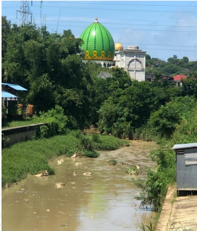
Gambar 4. 2 Penyempitan Dimensi Drainase Akibat Rumput Liar
