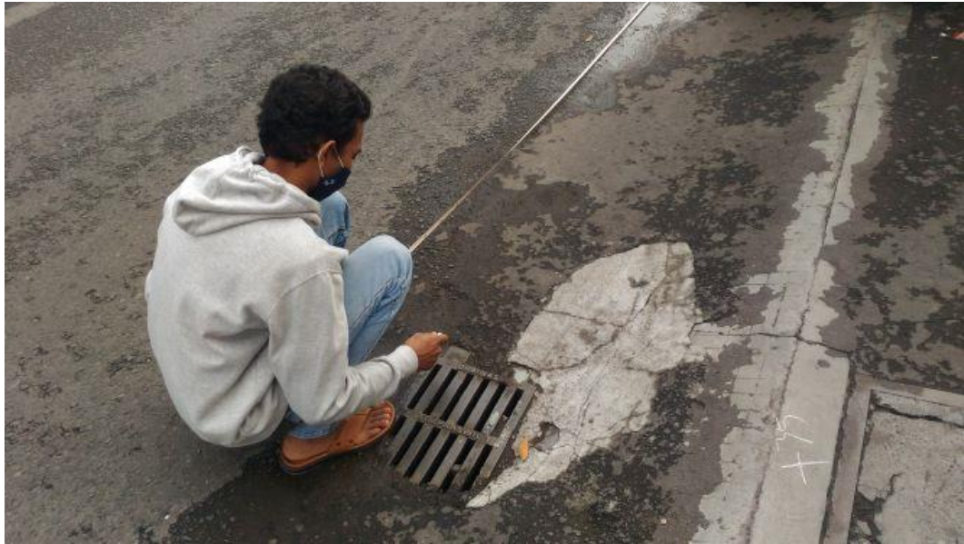
Pengambilan data kerusakan jalan akibat raveling
