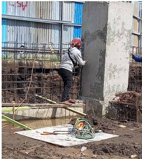
Gambar L-1.6 Pijakan Yang Digunakan Tidak Kukuh
