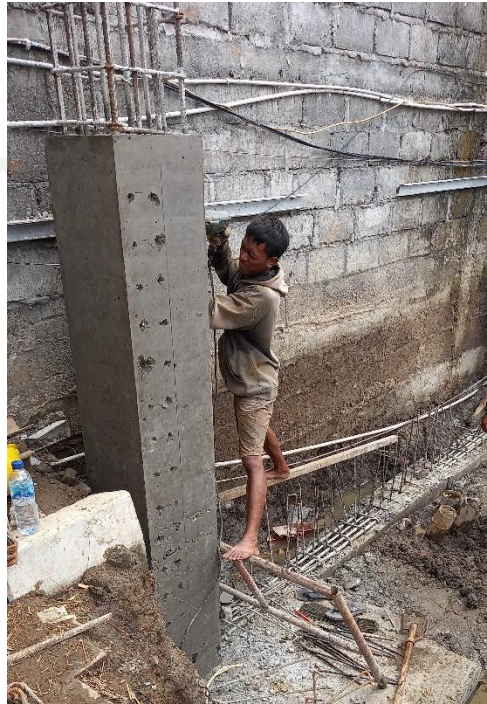
Gambar L-1.1 Pekerja Tidak Menggunakan Alat Pelindung Diri (APD)
