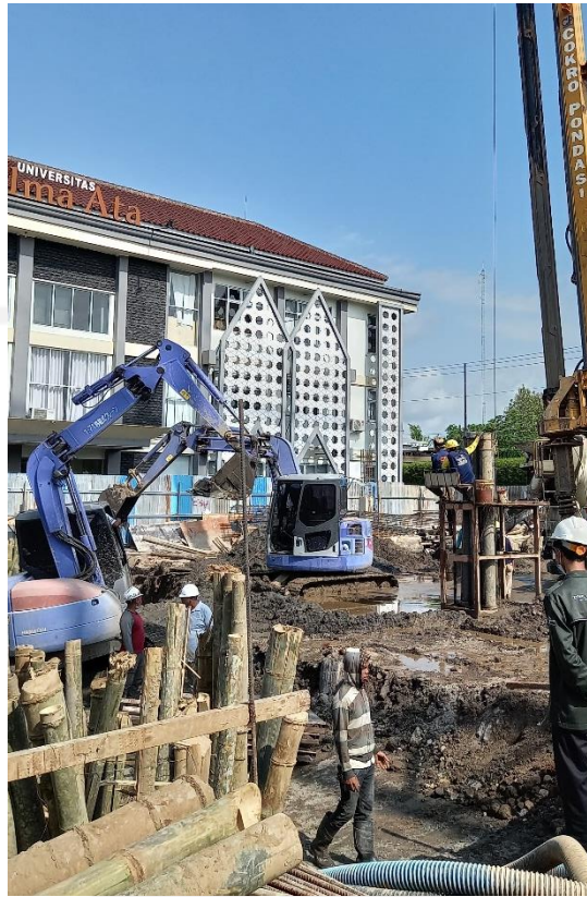
Gambar L-1.5 Area Kerja Yang Sempit
