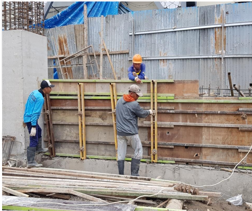
Gambar L-1. 2 Penempatan Kabel dan Area Kerja Berantakan
