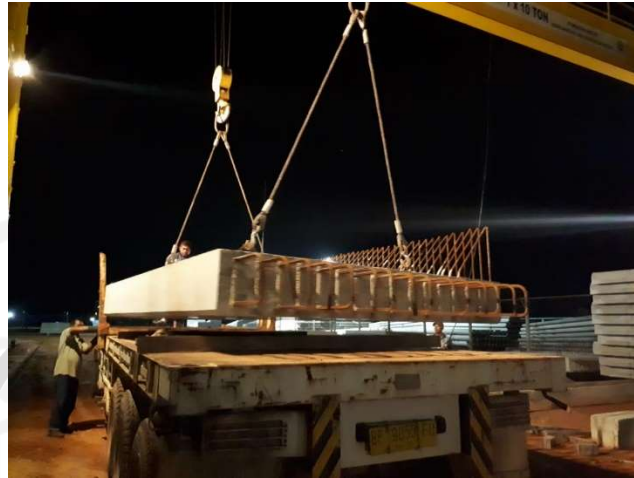
Gambar 5.9 Distribusi Full Slab dari Pabrik ke Pelabuhan di Kota Batam (Sumber : Dokumentasi Proyek)
