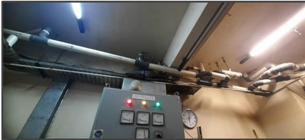
Gambar 4.2 Pipa air buangan pada Ruang Maintenance
