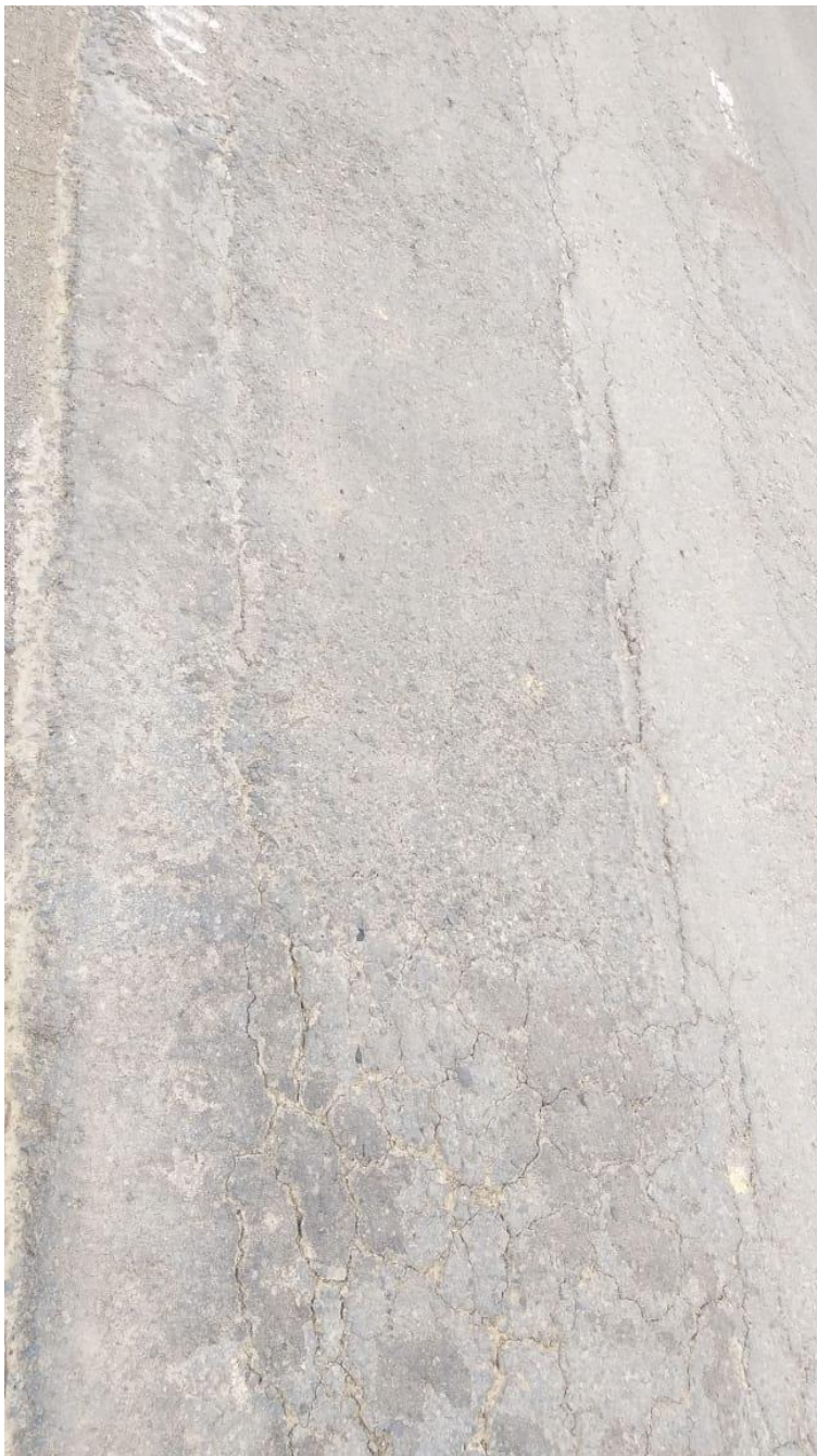
Lampiran 1 Gambar. 2 Kerusakan pada Ruas Jalan Kaliurang km 15-16
