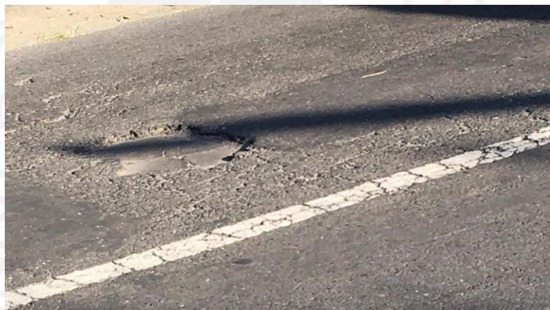
Gambar 1. 1 Kerusakan Lubang di Jalan Kaliurang km 15-16
