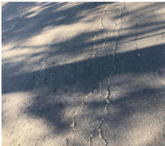
Gambar 1. 2 Kerusakan Retak di Ruas Jalan Kaliurang km 15-16
