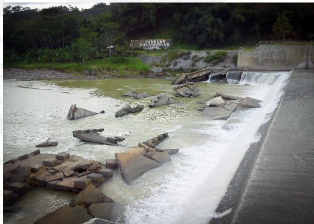
Gambar 1.1 Kerusakan Pada Kolam Olak di Bendung Kaligending
