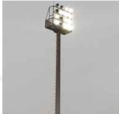
Gambar 2.25 Lampu Sorot Stadion Sumber: Google, 2021
