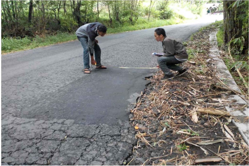
Gambar 1.3 Pengambilan data Crack dan Patching/Potholes .
