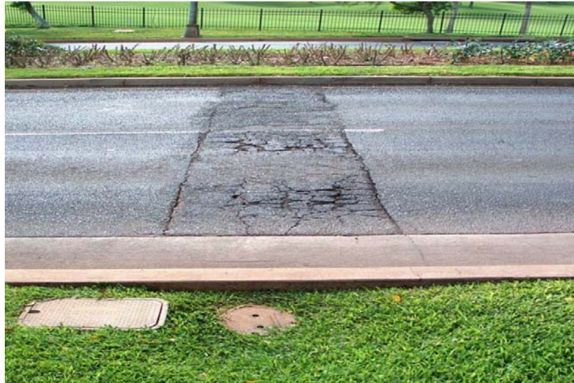
Gambar 3.14 Penurunan pada bekas penanaman utilitas ( Utility cut depression )
