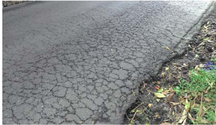
Gambar 3.2 Retak Kulit Buaya ( Alligator crack )
