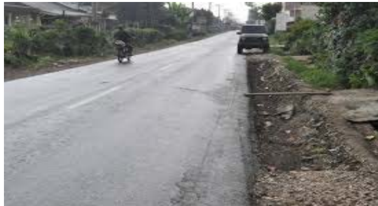
Gambar 3.3 Retak Pinggir ( Edge crack )
