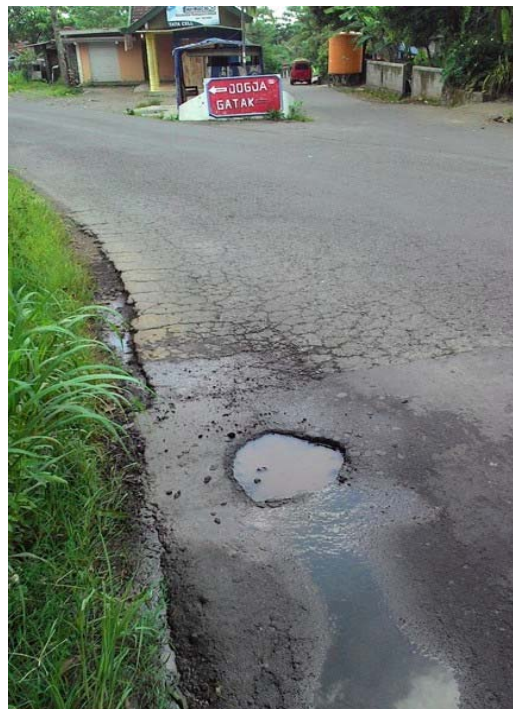
Gambar 1.1 Kondisi Perkerasan di Jalur Evakuasi Yang Terdapat Pothole pada tahun 2016
