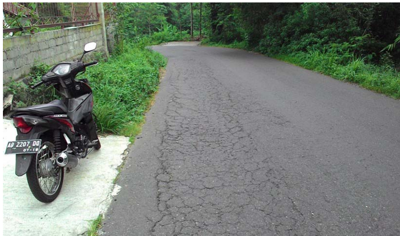
Gambar 1.3 Kondisi Perkerasan di Jalur Evakuasi Mengalami Alligator Crack pada tahun 2016
