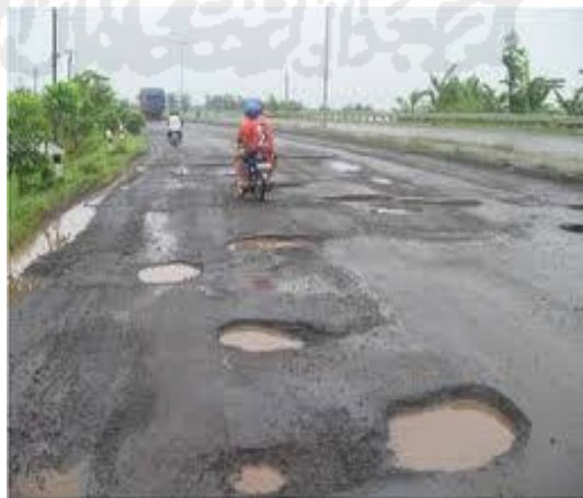
Gambar 3.3 Lubang ( potholes ) (Sumber : Mulyandari, 2011)
