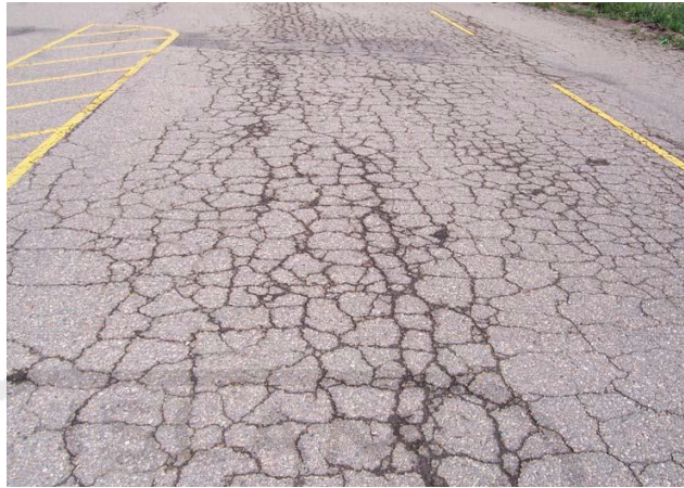
Gambar 3.2 Retak Kulit Buaya ( Alligator crack ) (Sumber : Mulyandari, 2011)
