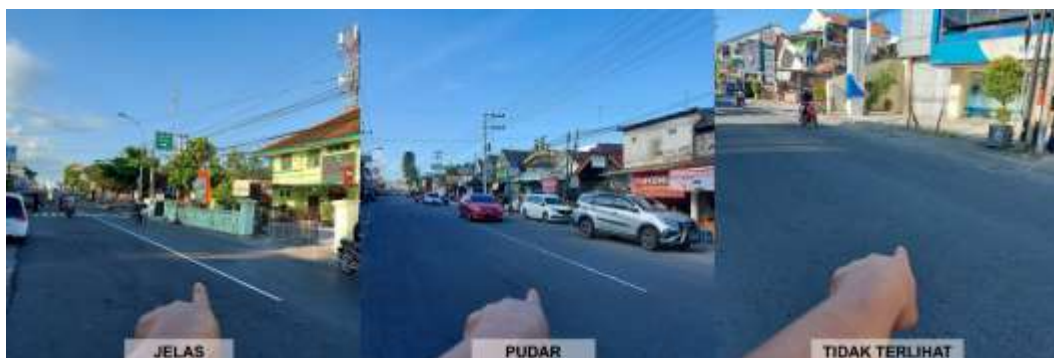
Gambar 5.18 Penilaian Kondisi Marka Jalan
