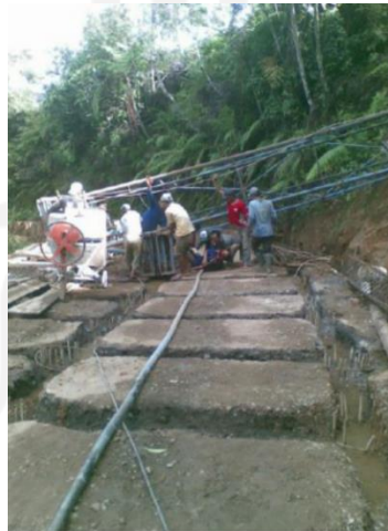
Gambar 1.1 Jatuhnya Crane Pada Saat Pekerjaan Bore Pile (sumber:www.JBerita.com)
