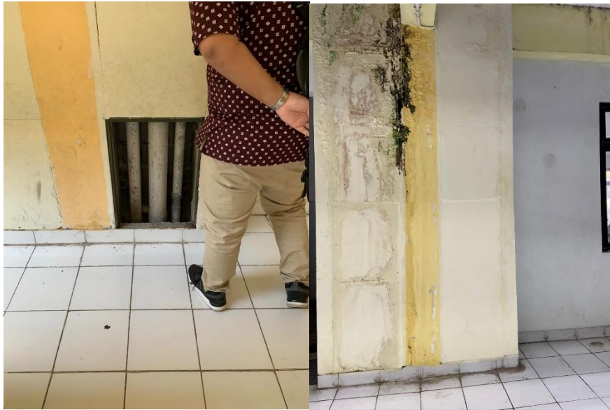
Gambar 5.3 Dinding Kalsiboard yang Rusak
