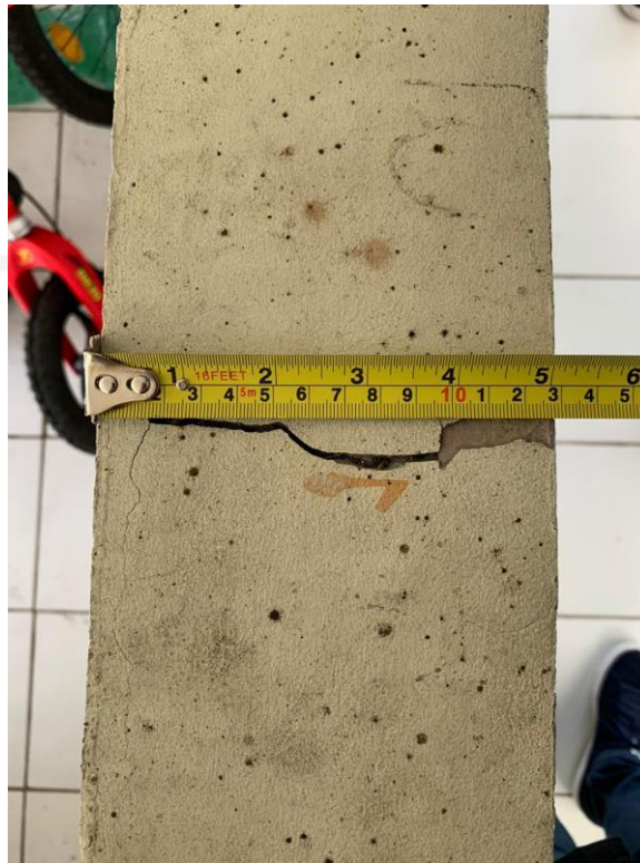
Gambar 5.10 Retak Halus pada Dinding
