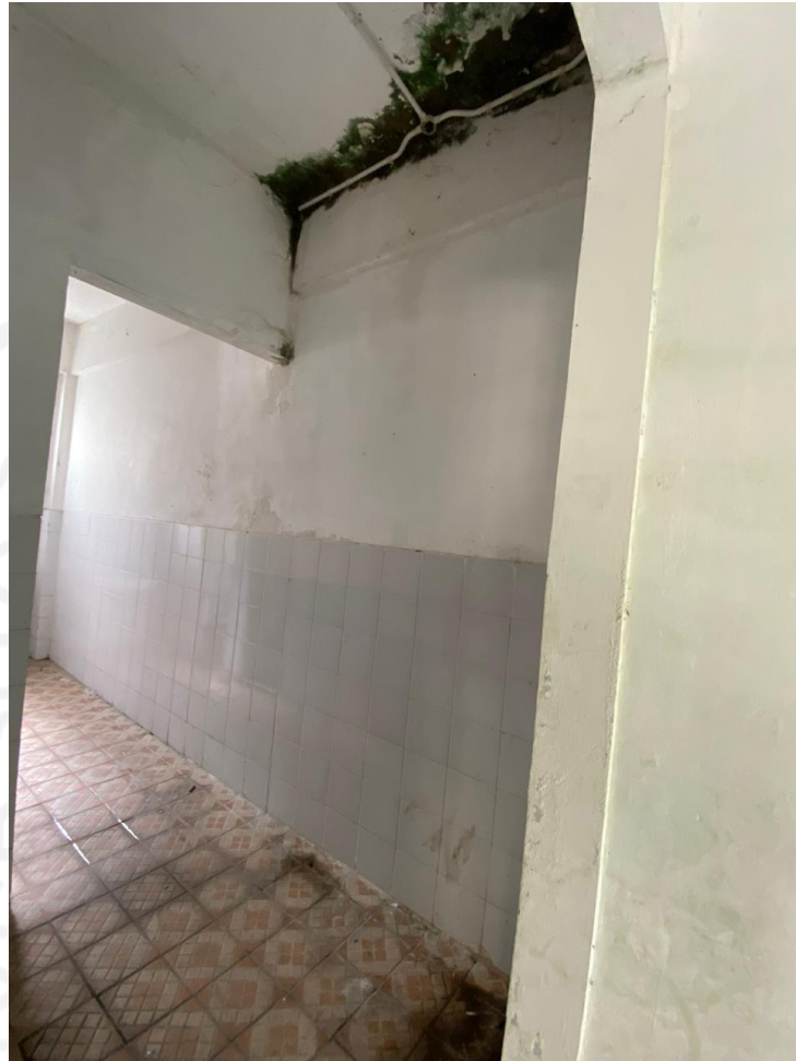
Gambar 5.7 Plat Lantai yang Mengalami Rembes
