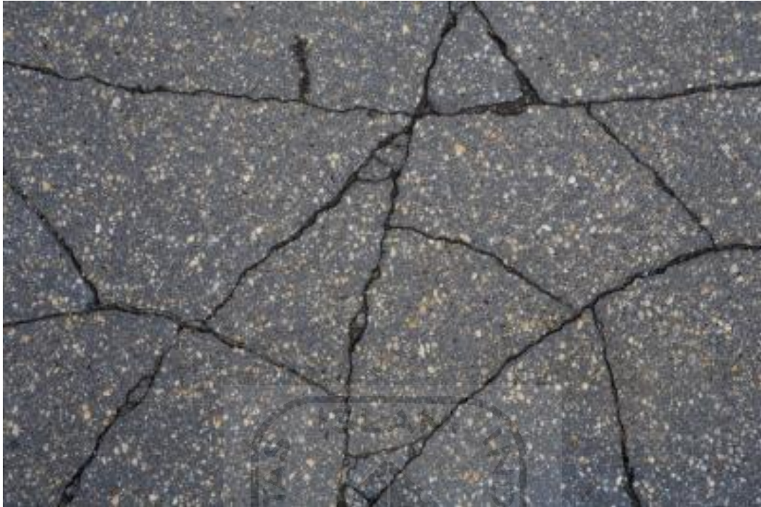
Gambar 3. Retak Blok ( Block Cracking )
