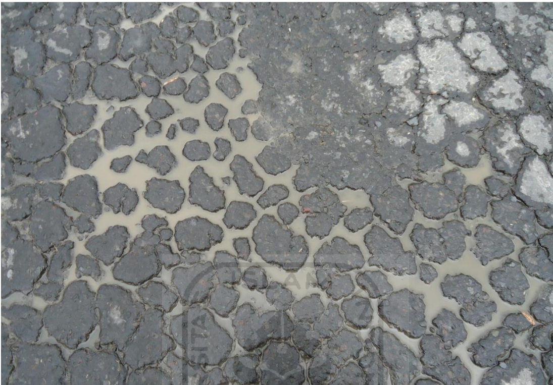
Gambar 1. Retak Kulit Buaya ( Alligator Cracking )
