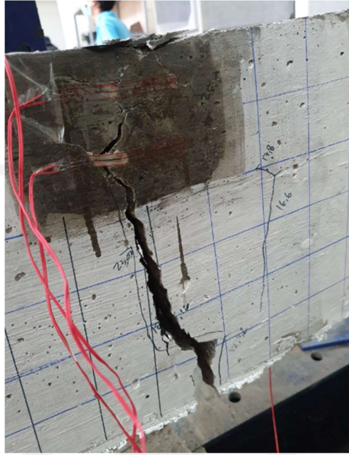
Gambar 5. 37 Kondisi Balok 8 Setelah Uji Lentur
