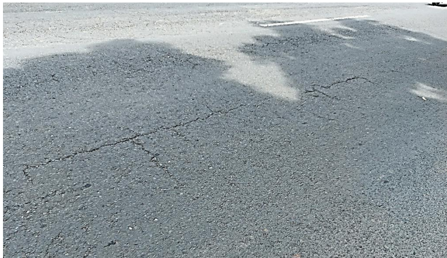
Gambar 3.7 Retak Memanjang ( Longitudinal Crack )
