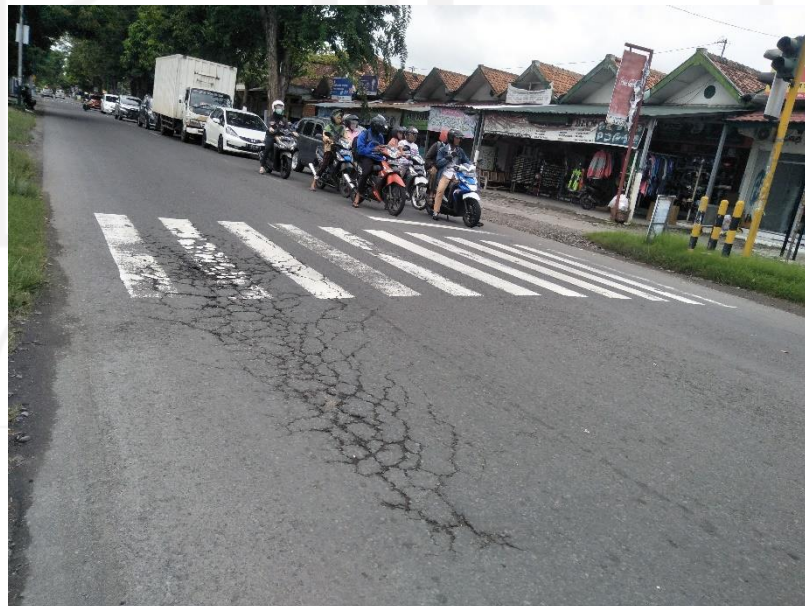
Gambar 1.1 Retak ( Cracking ) pada Ruas Jalan Parangtritis
