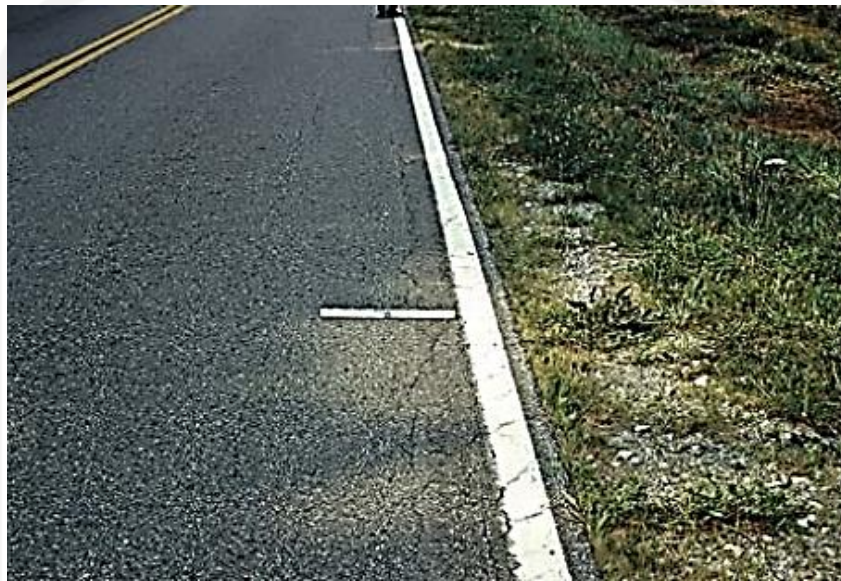
Gambar 3.10 Retak Pinggir ( Edge Cracking )
