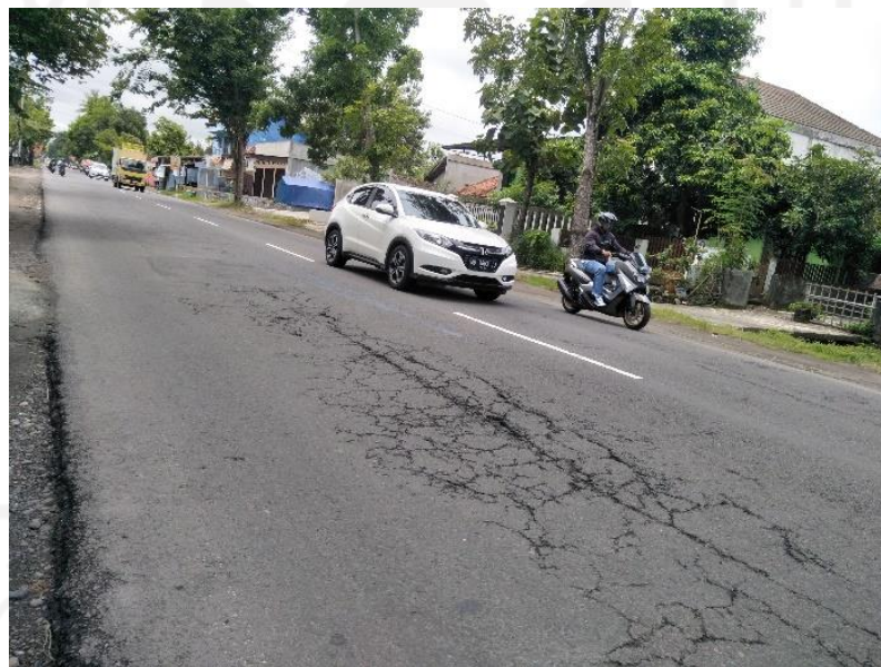
Gambar 1.3 Rutting pada Ruas Jalan Parangtritis
