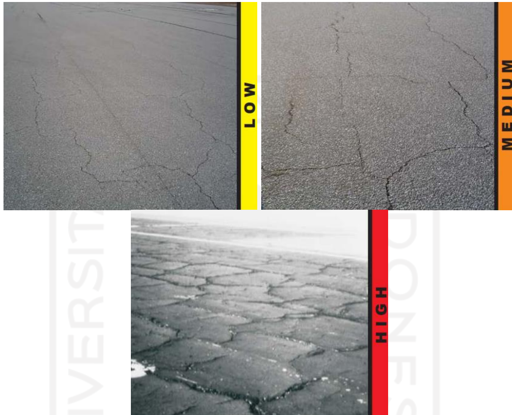
Gambar 3.9 Retak Blok ( Block Cracks )
