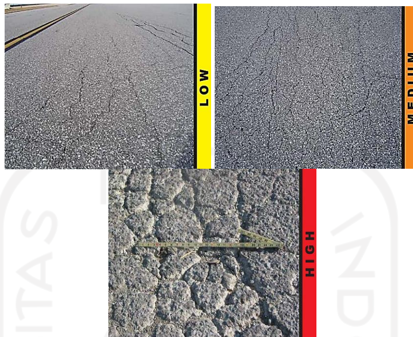
Gambar 3.8 Retak Kulit Buaya ( Alligator Cracking )
