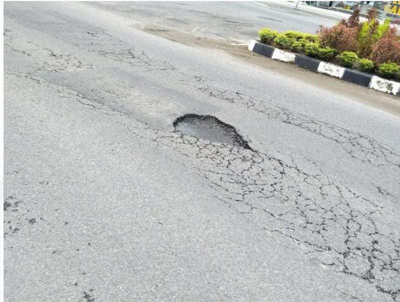
Gambar 1.2 Pot Hole dan Aligator Cracking pada Ruas Jalan Parangtritis
